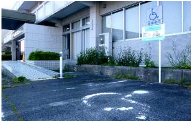
庁舎玄関の両サイドにある表示がほとんど消えている
