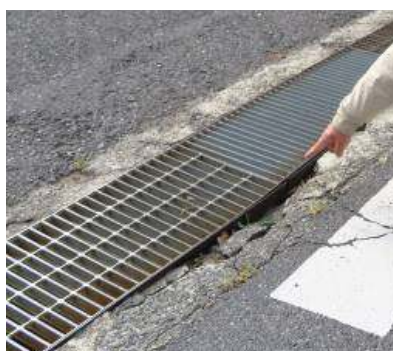
側溝のコンクリートが割れています
